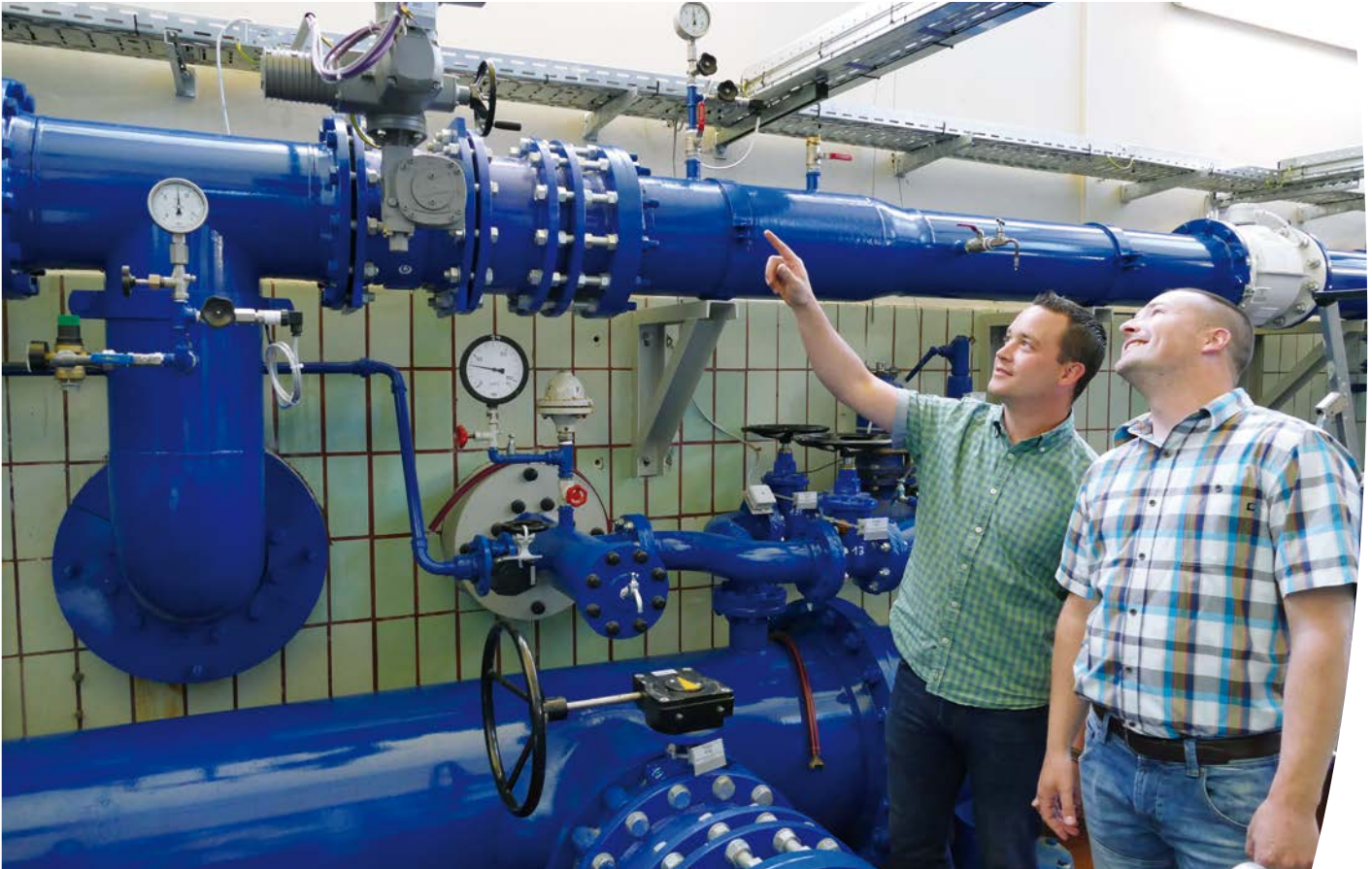
Fabian Schubert (l.) und Kollege Daniel den Toom inspizieren im Maschinenhaus des Wasserwerks einen Ventiltrieb, der natürlich auch Teil der geprüften Anlage ist.
